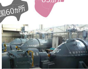
江見下流排水機場 佐賀県神崎市
